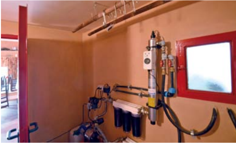
Potabilizzatore e adduzioni acqua
