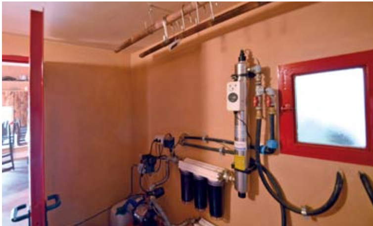
Trinkwasseraufbereitungsanlage und Wasserleitungen
